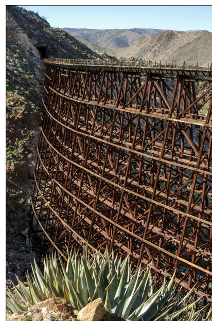
Рис. 8. Деревянный железнодорожный мост через каньон Гоат, г. Сан-Диего, США. Постройка 1932 г. Современное фото
